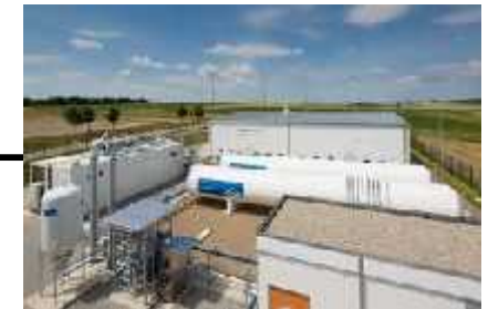
Elektrolyse, H 2 -Speicher, BHKW Modular erweiterbar
