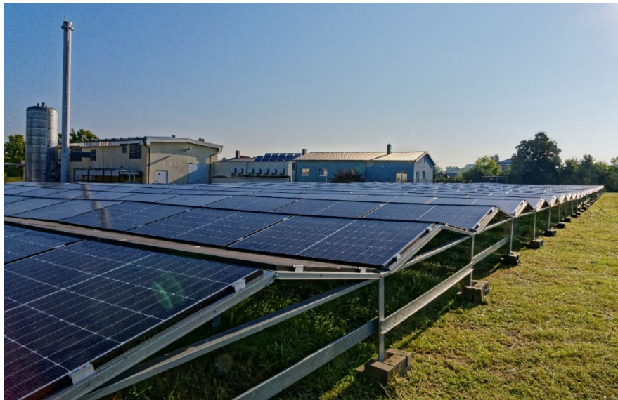
Anlage I - Magdeburger Straße mit 442 Modulen (194 kWp)*
