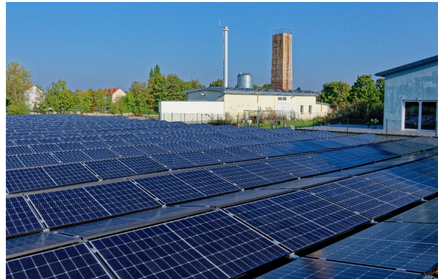
Anlage II - Süderstadt mit 712 Modulen (313 kWp)*
